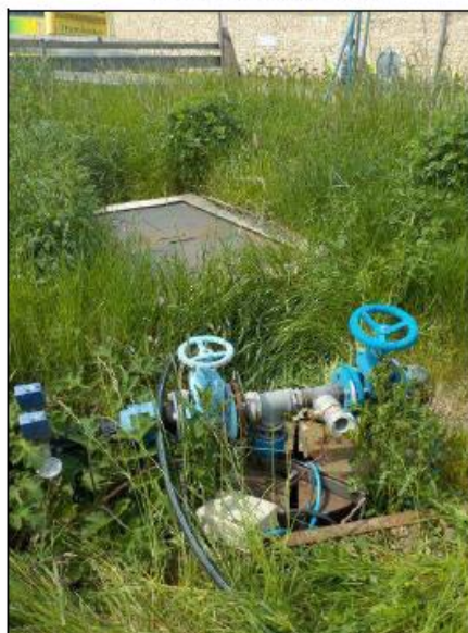
Puits et équipements
