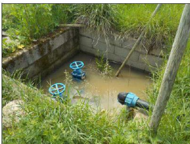
Equipements en sortie du puits
