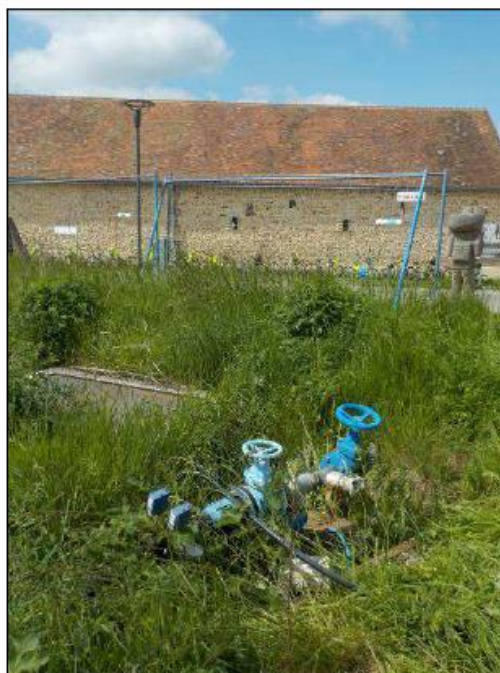
Puits et équipements
